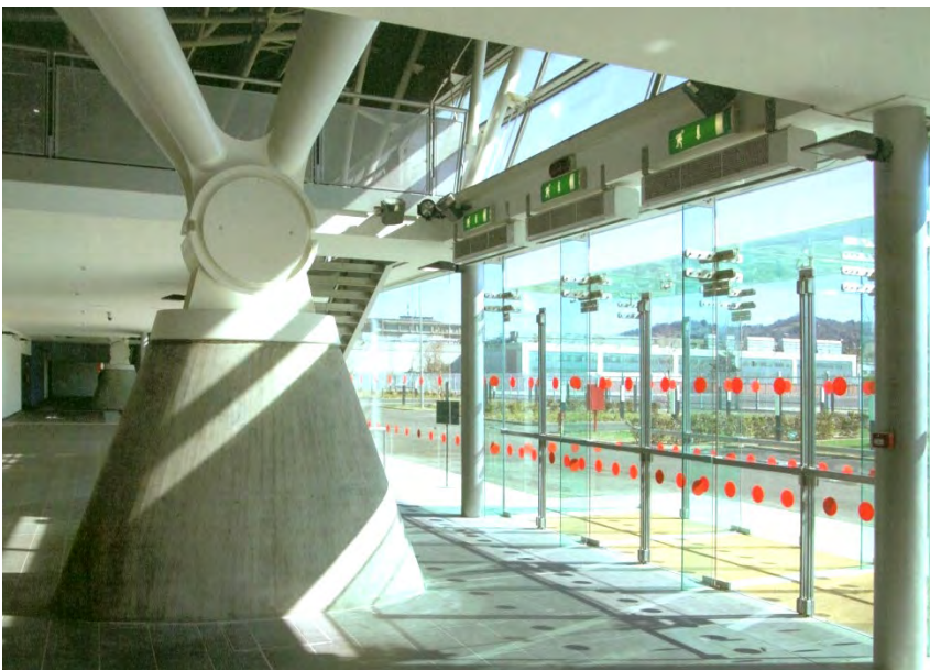
TORINO – PalaOval (Arch. Alessandro Zoppini, 2006) Schema di calcolo utilizzato per la verifica strutturale degli elementi di ingresso realizzati in vetro portante monolitico da 19 mm. Le connessioni tra le lastre vetrate sono realizzate con staffe e bulloneria in acciaio inox.
