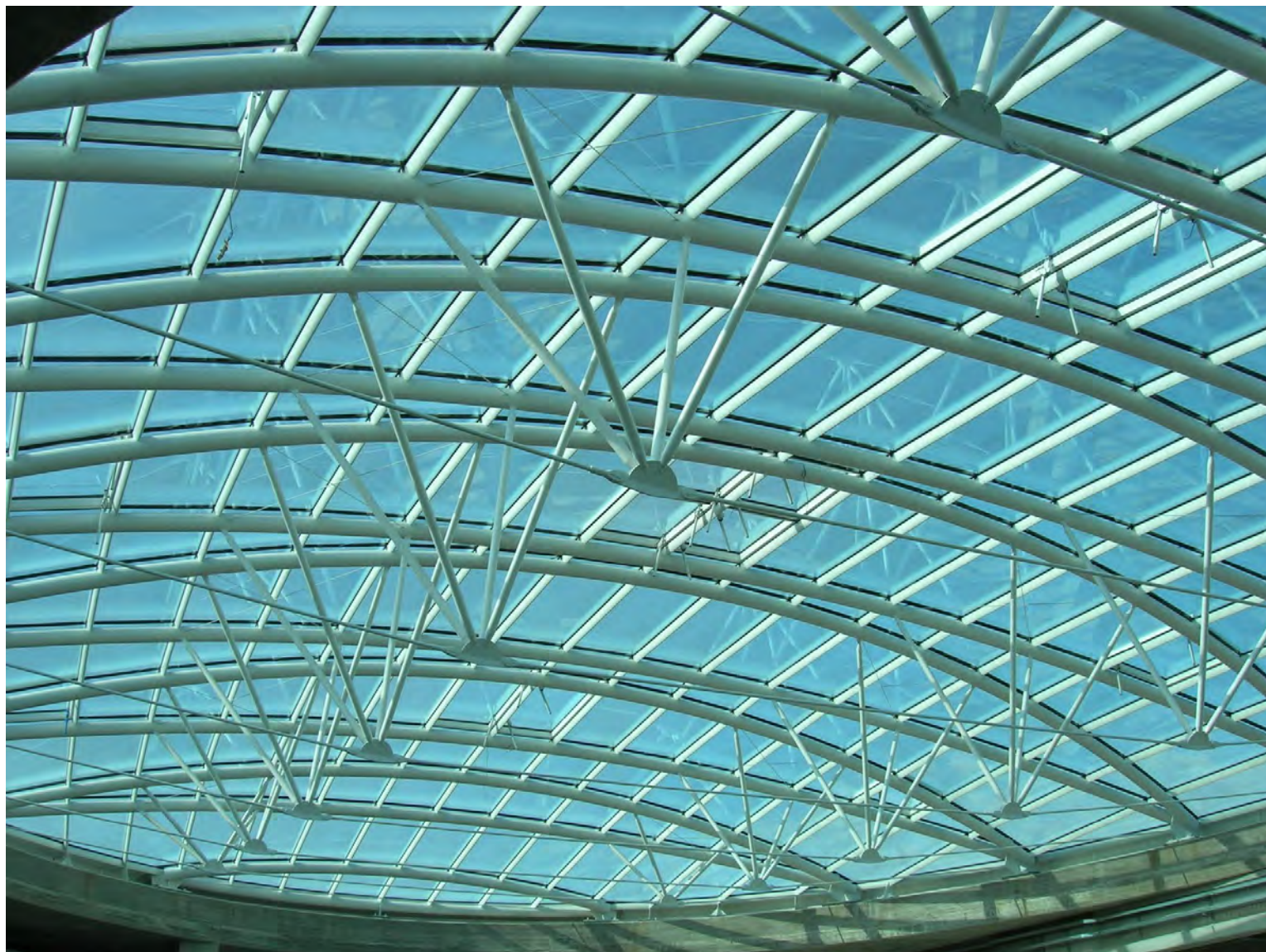
CASERTA – Centro commerciale ISE (arch. Ferdinando Iodice, 2005) Coperture a volta a base ellittica con strutture a lenti formate da doppio tubolare calandrato e tiranti, con vetro camera del tipo a siliconi strutturali; disegno completamente realizzato in 3D con uso di modellatori solidi per Inventor e Mechanical 2005, lato maggiore della cupola di 50 m.
