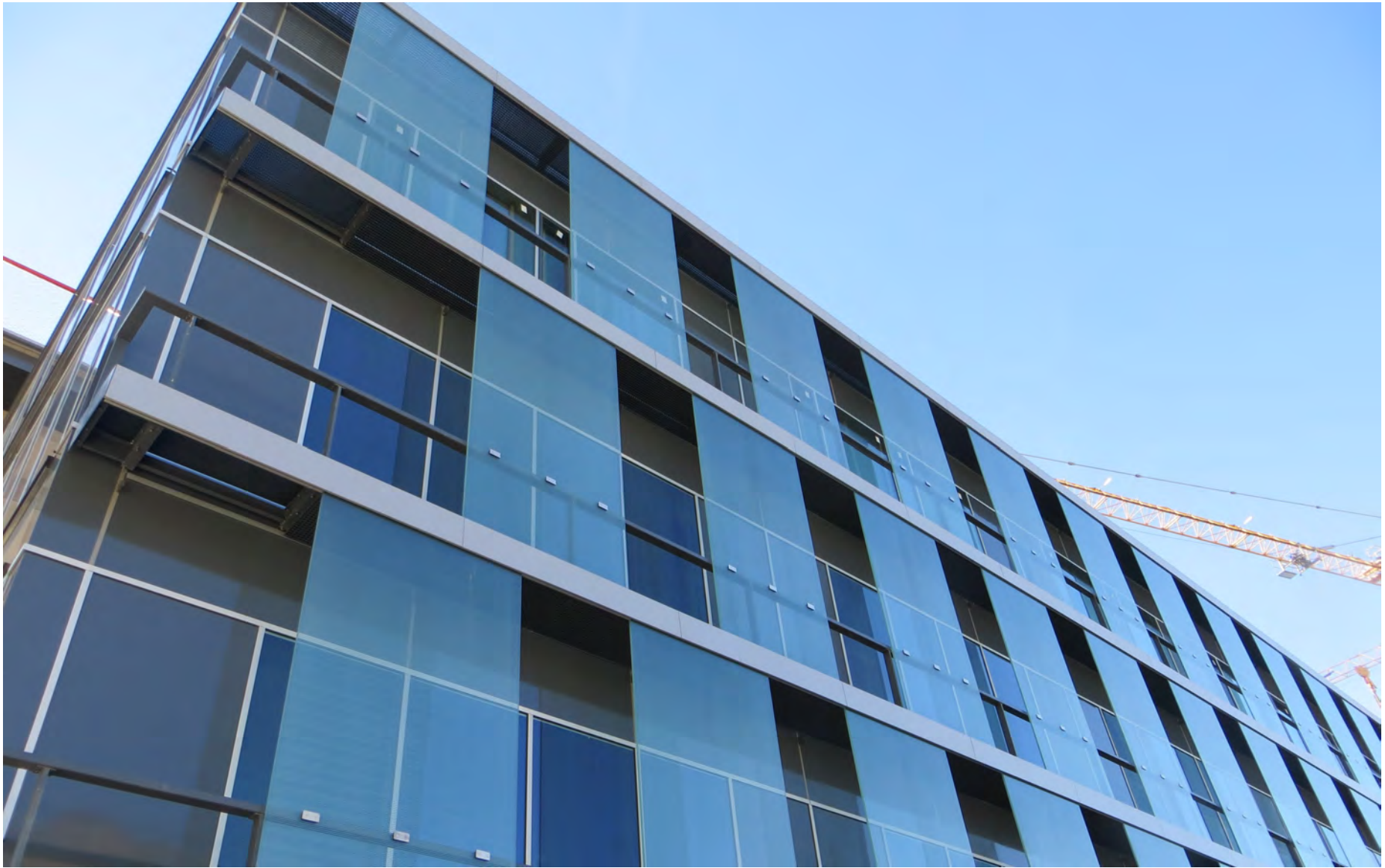
BOLZANO – Nuova Clinica Ospedale (in corso) Collaborazione specialistica per collaudo tecnico funzionale relativo all'appalto facciate riguardante l'ampliamento dell'ospedale.
